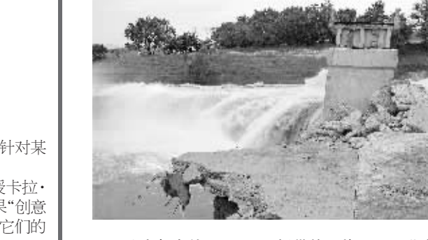
这张朝中社8月11日提供的照片显示,洪水对朝鲜主要产粮区黄海南道的设施带来损害。7月下旬开始的暴雨引发洪水,造成房屋倒塌,农田被淹,桥梁、公路以及水渠被毁。 新华社/朝中社
