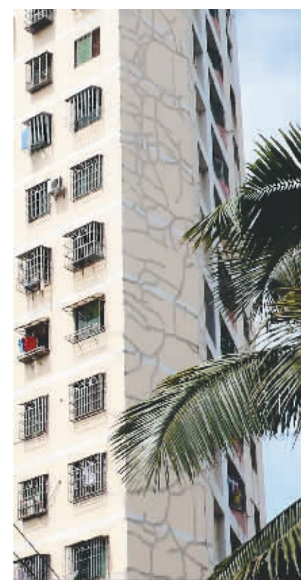
10月14日,海口府城一栋楼外墙壁上满是解决防水防漏填补上去的“裂缝”。
