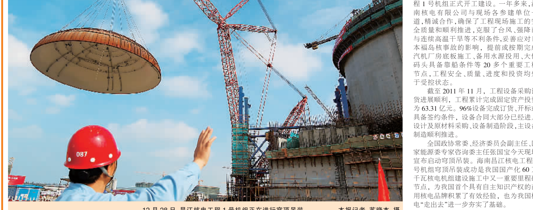
12月28日,昌江核电工程1号机组正在进行穹顶吊装。 本报记者 苏晓杰 摄
