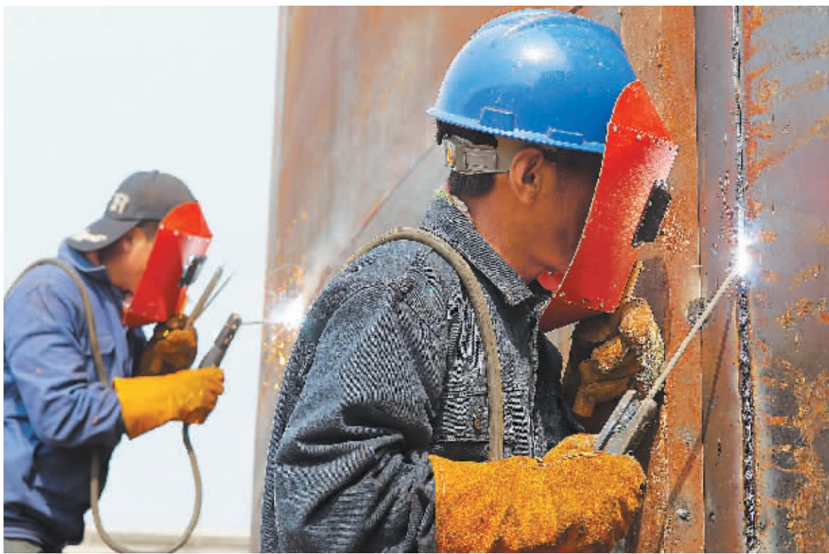
位于老城经济开发区的精细化工项目建设工地,工人们头顶烈日在焊接油罐。
