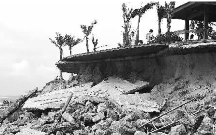
博鳌万泉河入海口处,某楼盘建在沙滩上的景观设施由于距海滩较近,建成不久就被风浪冲得七零八落,加上近日受热带风暴“泰利”影响,二三百米长的海堤被浪潮完全冲毁。一些游人在没有警示的坍塌处逗留玩乐,令人担心。 特约记者 蒙钟德 摄
