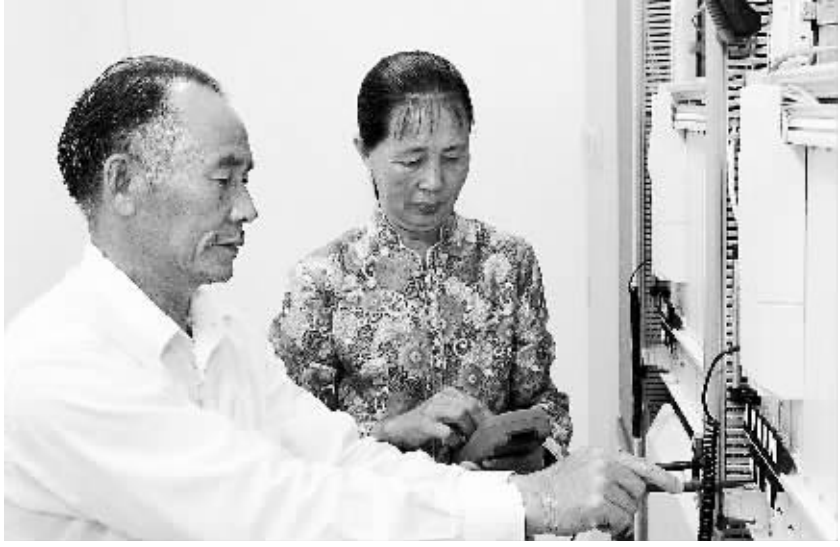
8 月 9 日傍晚,林武顺、陈香夫妇在尖峰岭微波站机房观察相关数据。本栏照片均由本报记者 苏晓杰 摄
