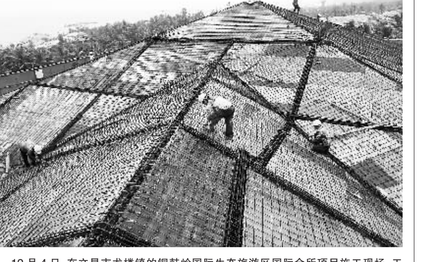
12月4日，在文昌市龙楼镇的铜鼓岭国际生态旅游区国际会所项目施工现场，工人正在冒雨绑扎扎面顶的钢筋。本报记者 宋国强 摄
