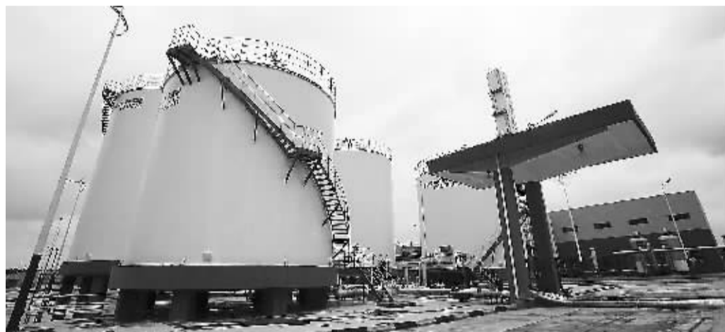
作为航天发射场配套项目之一的液氢液氧工程日前已全部建成,即将交付使用。该项目生产的产品将通过装车平台运往海南航天发射场,保障发射场的燃料供应。 本报记者张杰 通讯员黄兹志 摄
