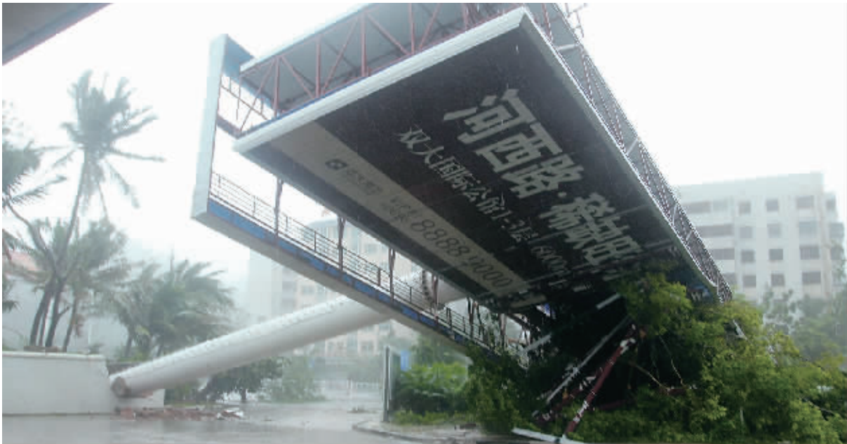
三亚市凤凰路一加油站附近，巨型广告牌被台风吹倒。
