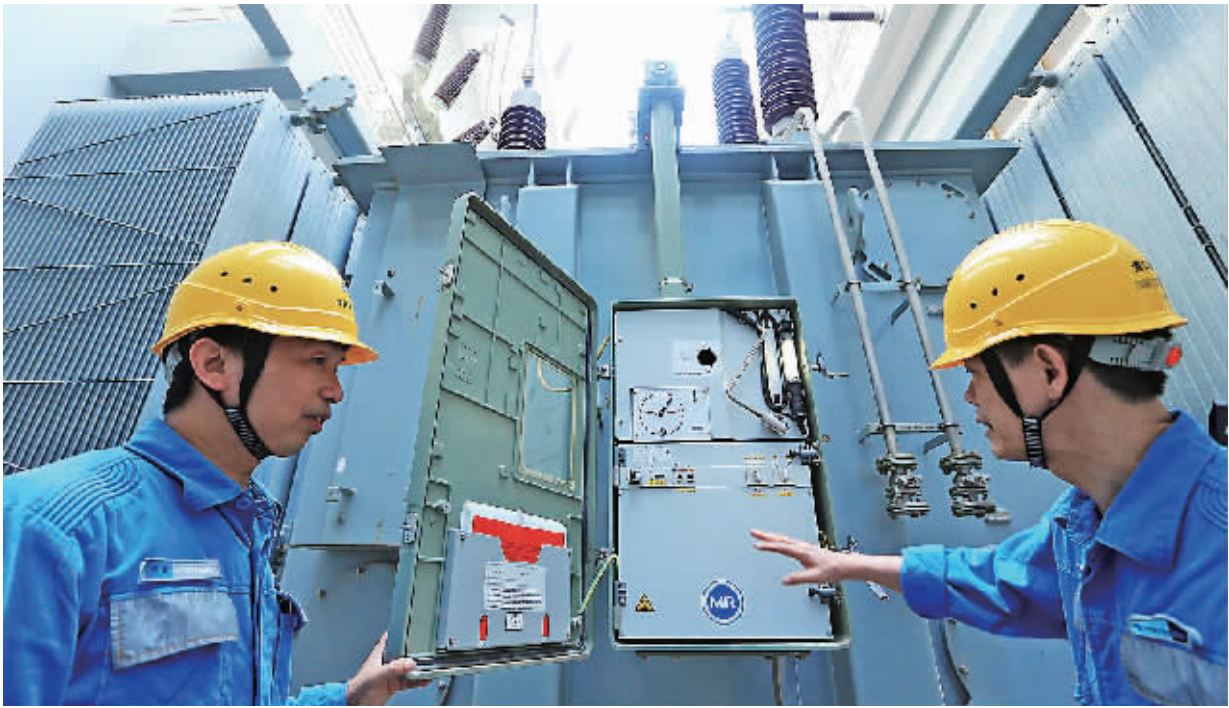
巡检排查线路 应对用电高峰
