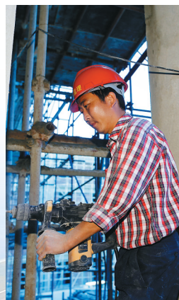
2013年12月2日，三沙市重点项目——永兴公用住房施工现场，工人正在打护栏安装孔。本报记者 宋国强 摄
