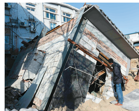
1月28日，一名工作人员在北京市德内大街93号院塌陷现场查看倒塌的建筑。目前塌陷大洞已用水泥灌注填补。 新华社记者 罗晓光 摄
