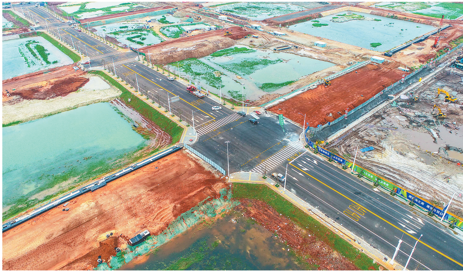
10月20日,俯瞰正在建设中的海口江东新区起步区路网项目部分路段。 本报记者 张茂 摄
