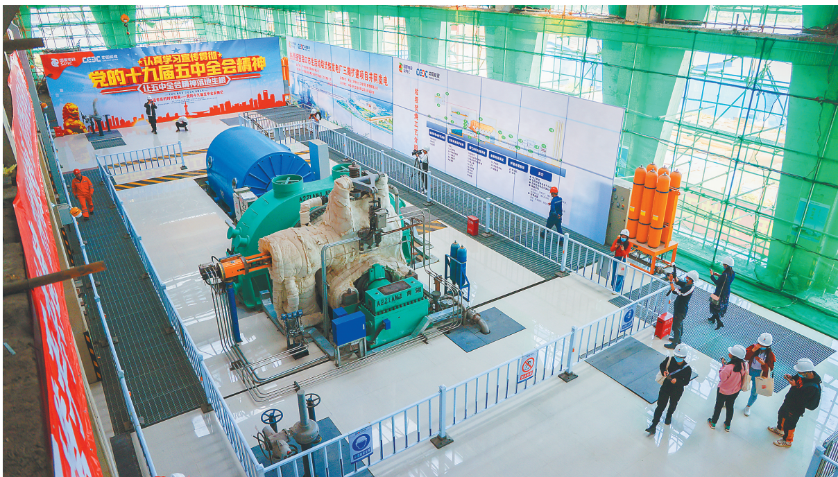
12月28日，位于澄迈县老城经济开发区的海口市生活垃圾焚烧发电三期项目点火运营。图为汽轮机在工作。本报记者 袁琛 摄
