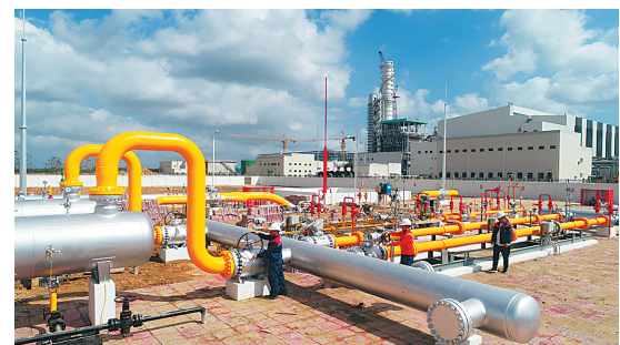
海南环岛天然气管网文昌—琼海—三亚输气管道工程文昌段，工作人员在进行巡检。阮琛摄
