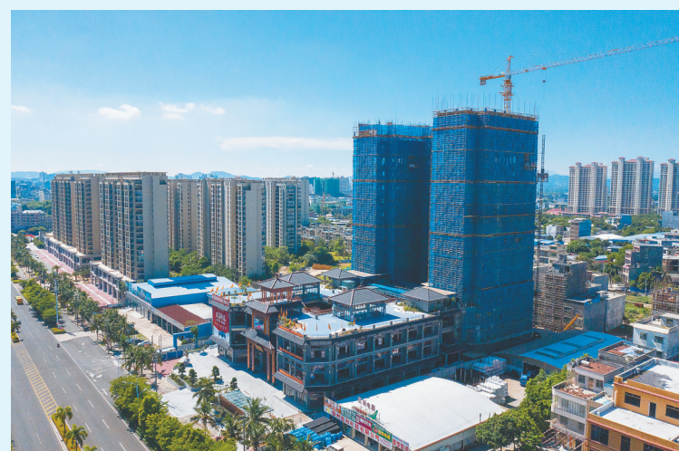
近日，位于那大镇中兴大街西段南侧的儋州·新福城商业街项目正在加紧施工。羊文彪 摄
