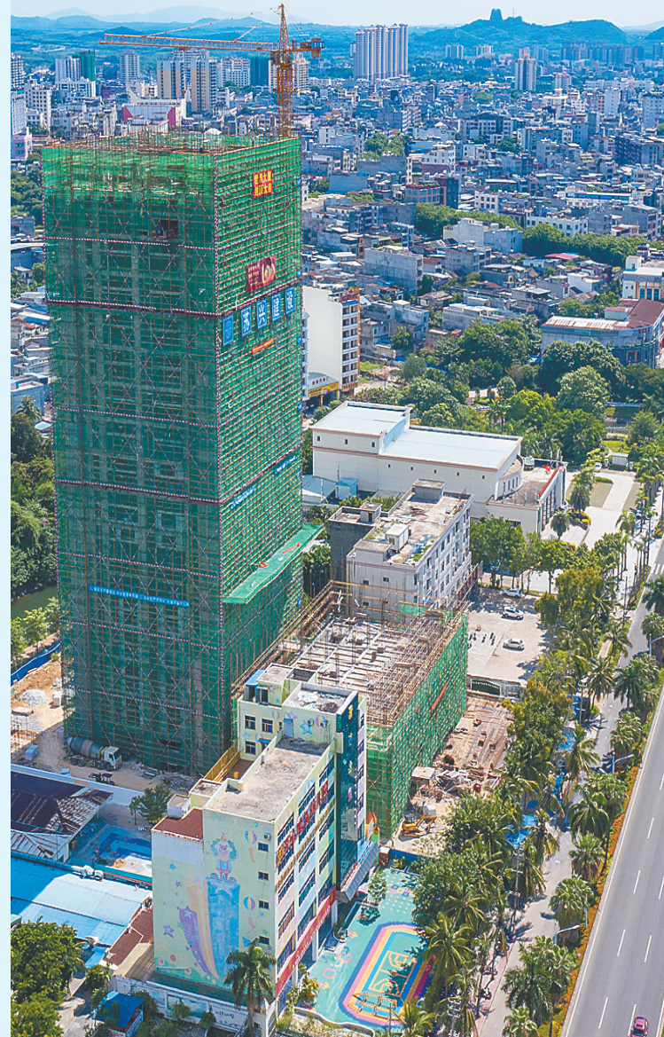
位于那大镇中兴大街的世博大厦项目主体结构已封顶。羊文彪 摄
