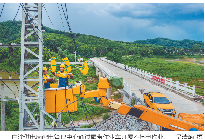
白沙供电局配电管理中心通过履带作业车开展不停电作业。 吴清炳 摄
