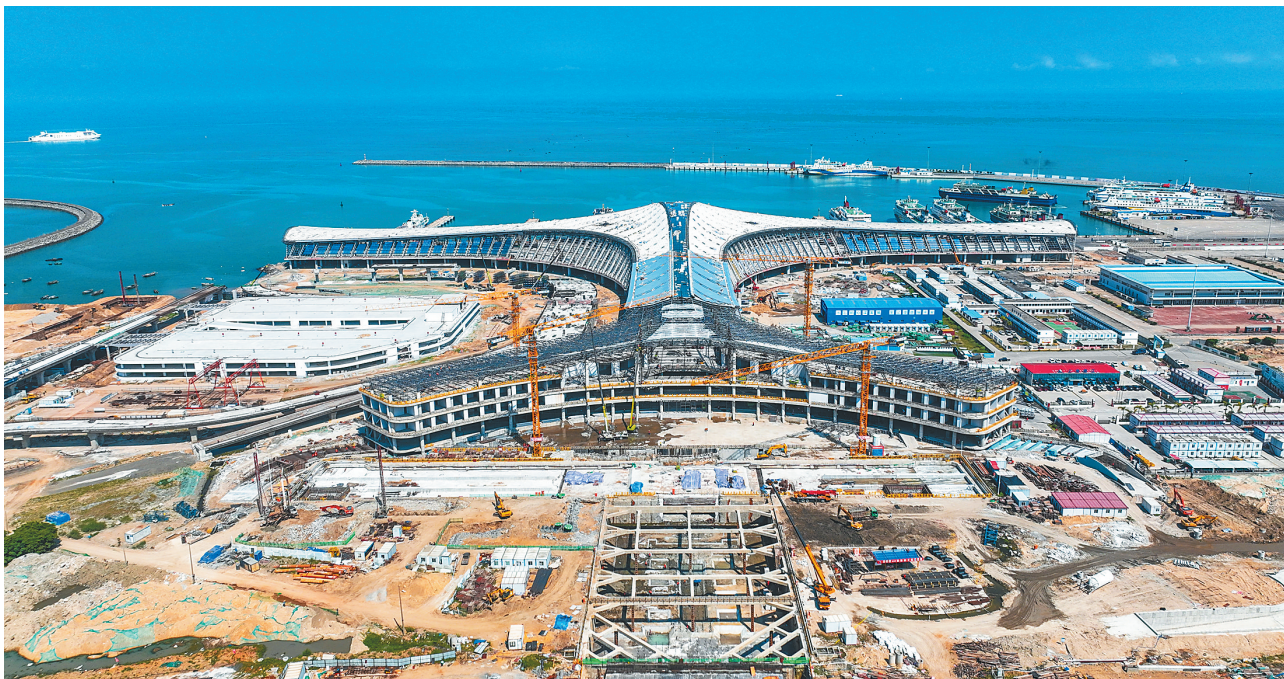
海口新海滚装码头客运综合枢纽项目: 主体建筑已现雏形
