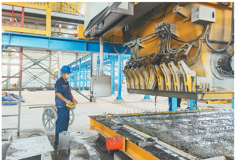
海南全景装配式建筑科技有限公司厂区内，一名工人正在操作混凝土布料机。
