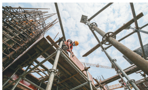
工人在海医一附院江东院区项目施工现场作业。 新华社记者 张丽芸 摄
