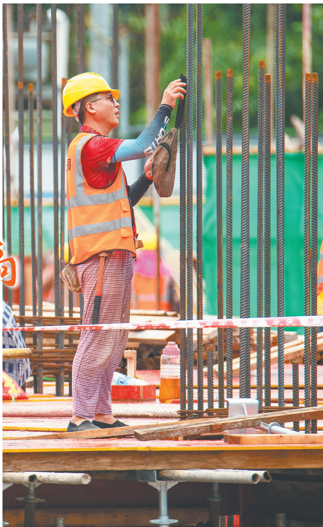
9月9日,博鳌乐城先行区一工地,建筑工人在大雨间隙加紧铺设模板。 特约记者 蒙钟德 摄
