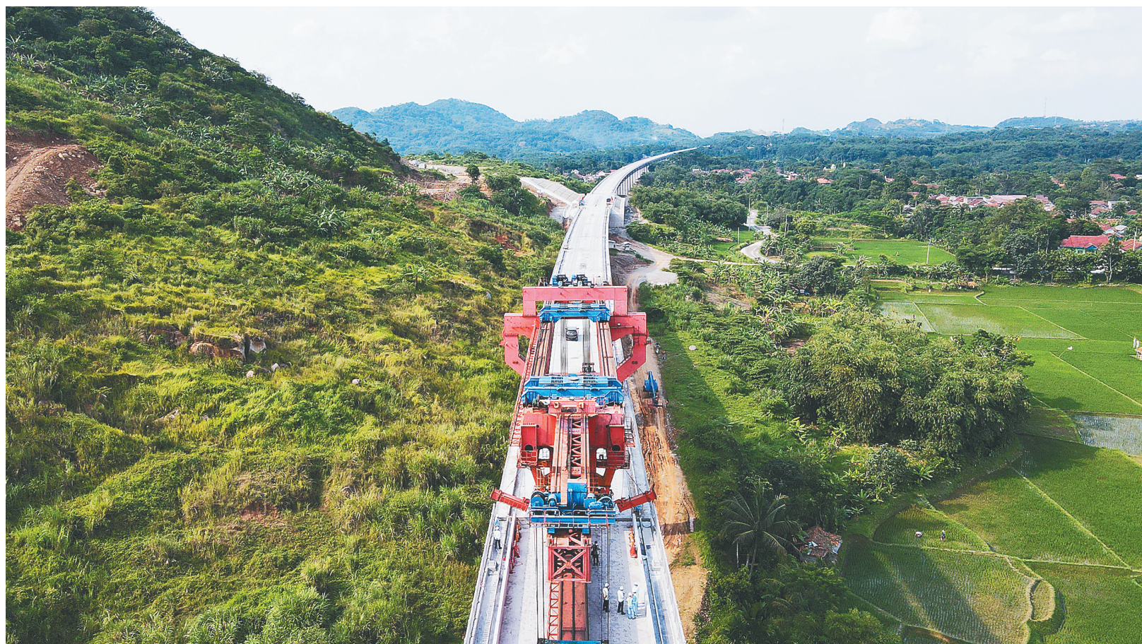
这是10月16日在印度尼西亚西爪哇省普哇加达县拍摄的雅万高铁全线最后一根箱梁架设施工现场。 新华社发
