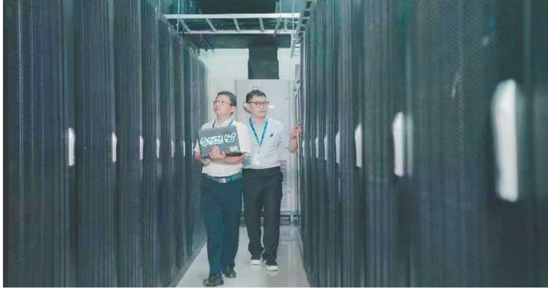
移动公司工程师在机房进行千兆网络运行巡检。 本版图片均由三亚市科工信局提供
