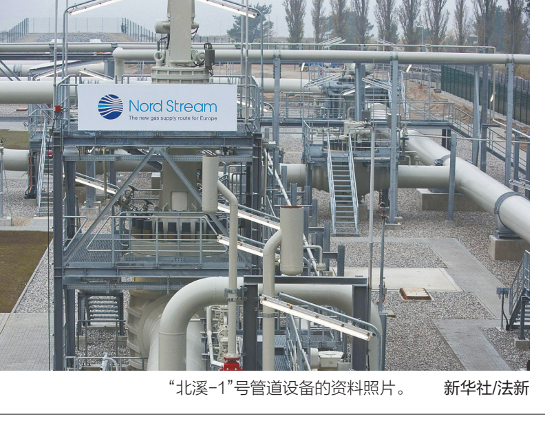
“北溪-1”号管道设备的资料照片。 新华社/法新
