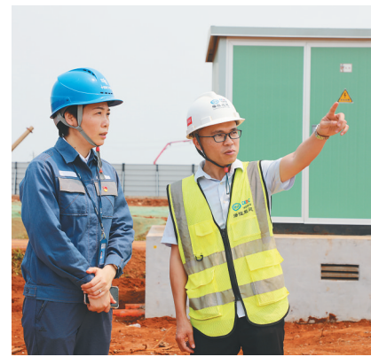
南方电网海南电网公司客户经理（左一）到海南医学院桂林洋校区一期项目施工现场走访，主动靠前服务。
