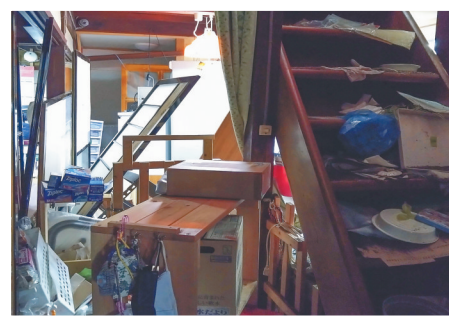
1月2日在日本石川县轮岛拍摄的一栋遭地震破坏的建筑内部。
