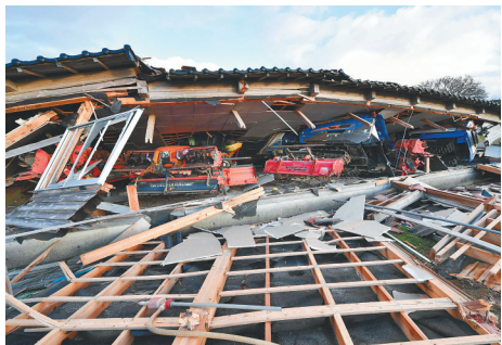
1月2日,在日本石川县轮岛市,一处倒塌的民房压在农具和车辆上。
