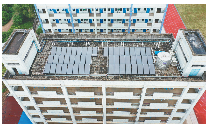
定安县城南中学学生宿舍热水供应系统。通讯员 张博 摄
