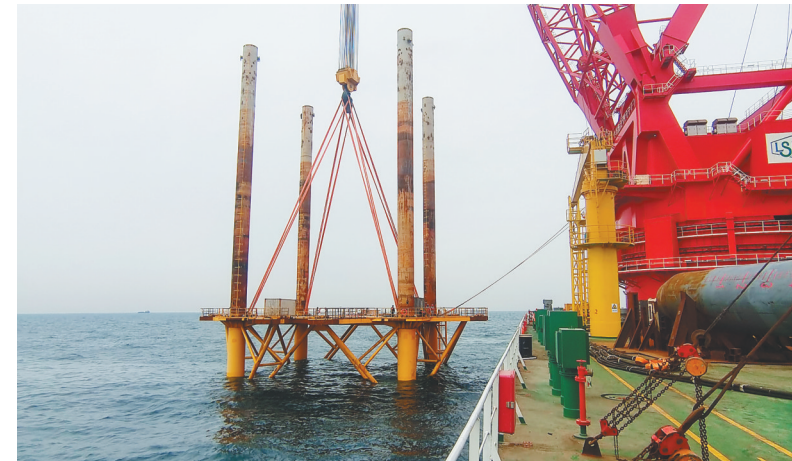
1月28日，中企CZ2、大唐CZ3海上风电项目集中开工仪式在儋州市举行，图为大唐CZ3项目正在进行海上施工。 本报记者 武威 通讯员 刘刚 摄
