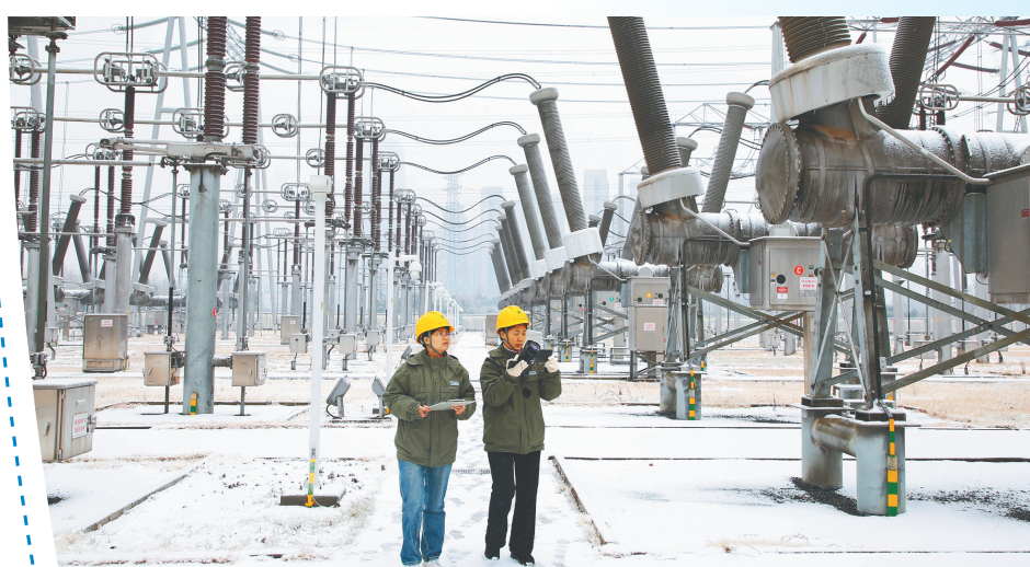
2月4日,在位于合肥市肥西县的500千伏肥西变电站,国网合肥供电公司变电运维值班员使用红外测温仪开展低温设备特巡。 新华社发
