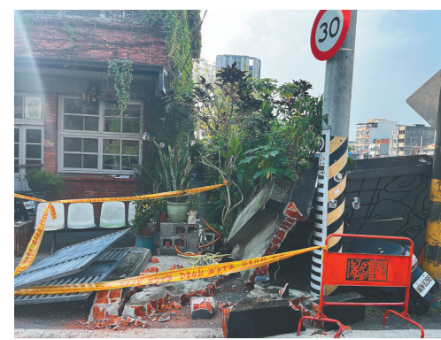
图为4月4日在花莲县花莲市区福建街拍摄的一处房屋，其墙体在前一天的强震中坍塌。新华社记者 赵博 摄
