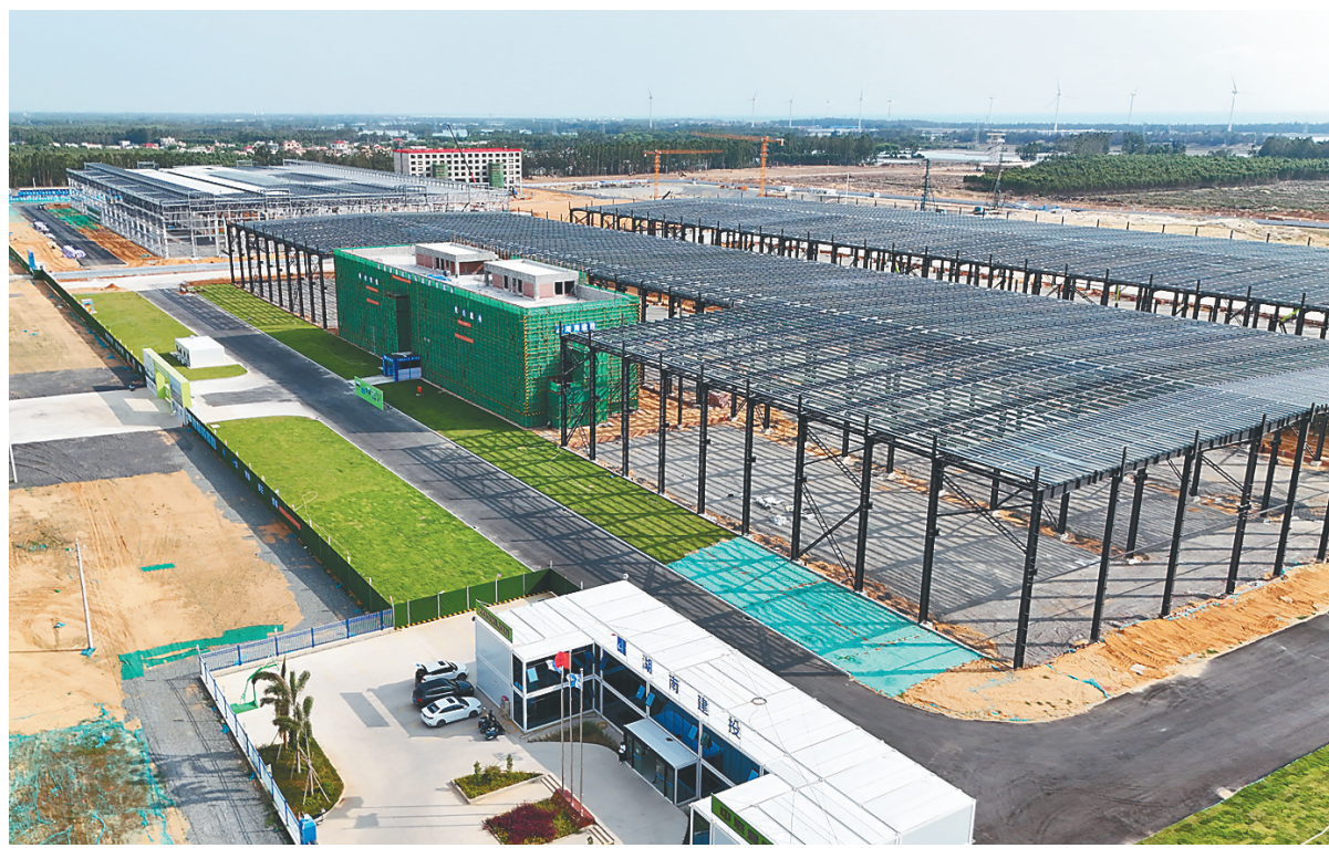
建设中的中联海南国际高端装备产业园项目。(受访者供图)
