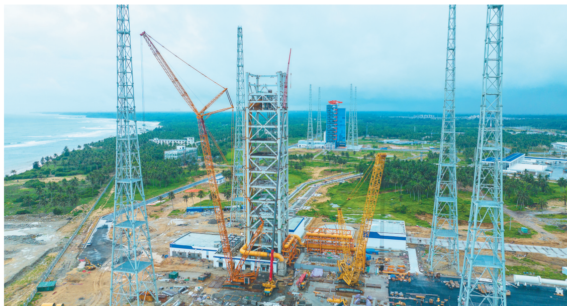
五月三十一日，海南国际商业航天发射中心一号发射场建设现场。本报记者 袁琛 摄
