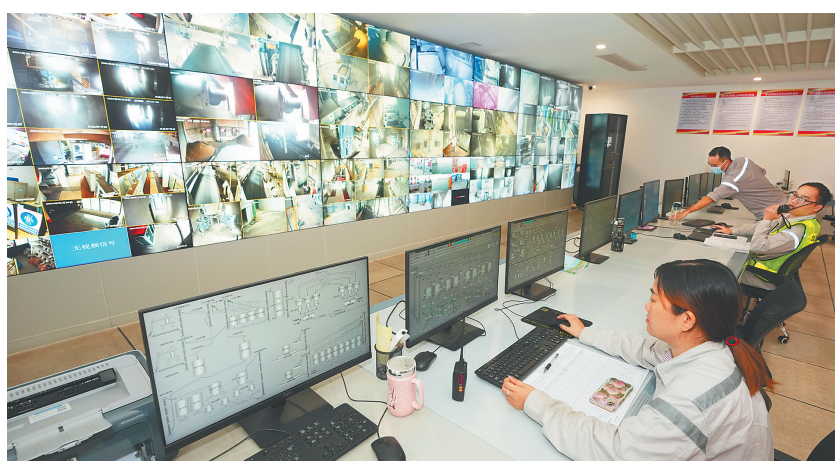
在海南昆仑集团有限公司中控室,工作人员通过智能系统有序操控水泥生产。 本报记者 陈元才 摄
