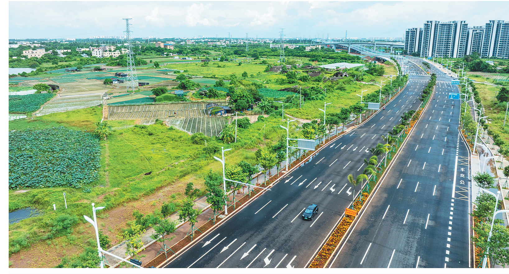
海口江东新区海文北路项目整体进度完成约95%。7月16日，航拍海口江东新区海文北路。目前，海文北路项目整体进度完成约95%，正在向完工发起最后冲刺。海文北路连接江东大道与海文高速，建设道路总长2.99公里，建成后将对区域路网结构的完善、周边地块的开发等起到重要作用。文/海南日报全媒体记者 刘梦晓 图/海南日报全媒体记者 李天平
