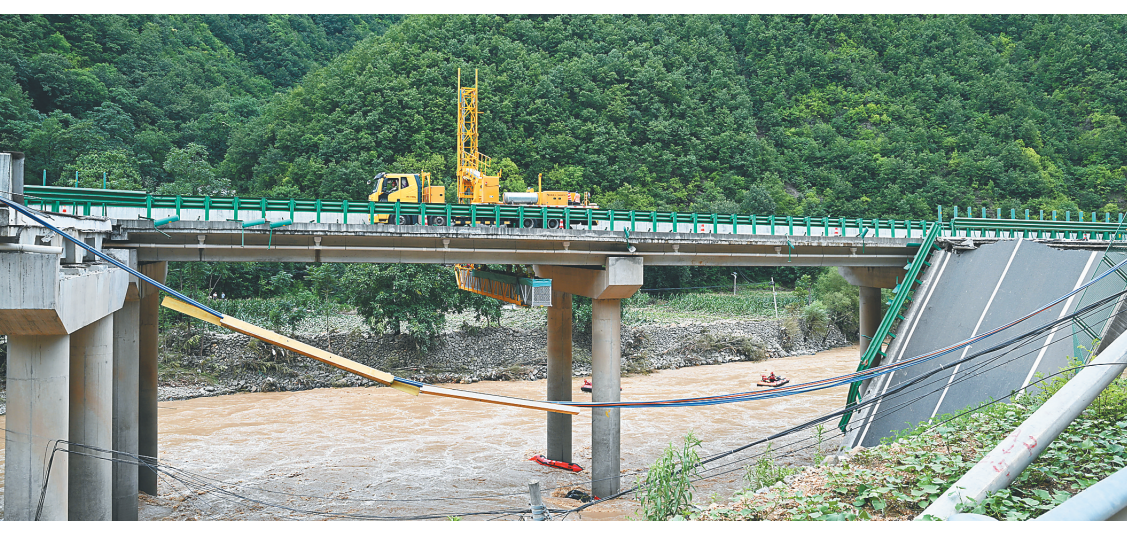
七月二十日,在陕西柞水高速公路桥梁垮塌现场,救援人员正在进行搜救工作。新华社发
