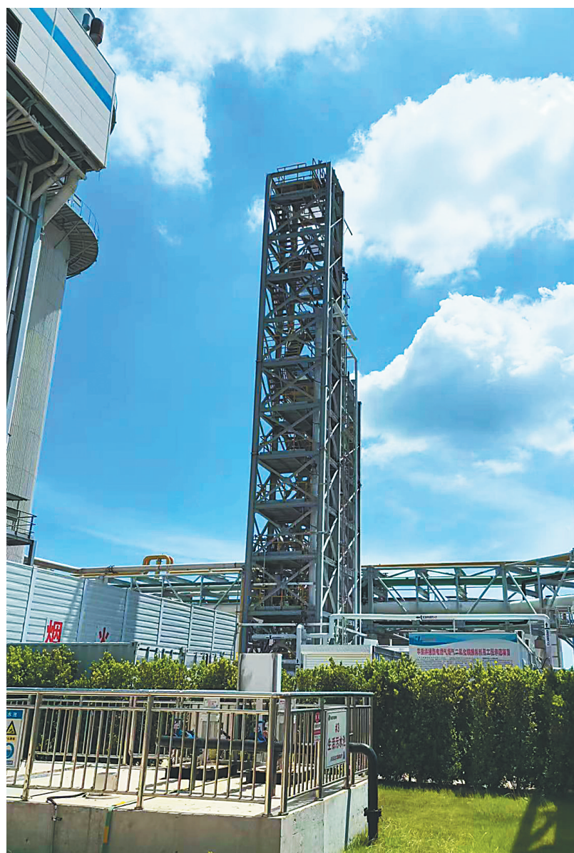
数十米高的塔器装置里安装有吸收塔、再生塔等设备，是燃气烟气二氧化碳捕集装置的主要设备之一。 海南日报全媒体记者 林书喜 摄
