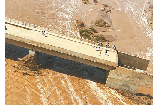
图为8月26日在苏丹红海州拍摄的溃坝洪水冲毁的大桥。 新华社发
