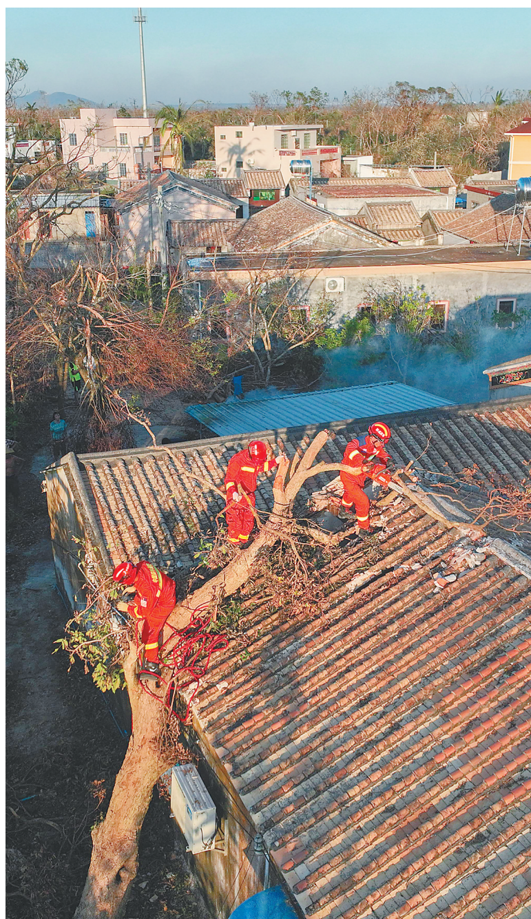
9月12日，文昌市冯坡镇鹿户村，文昌消防救援队对砸破房屋的树木进行清理。
