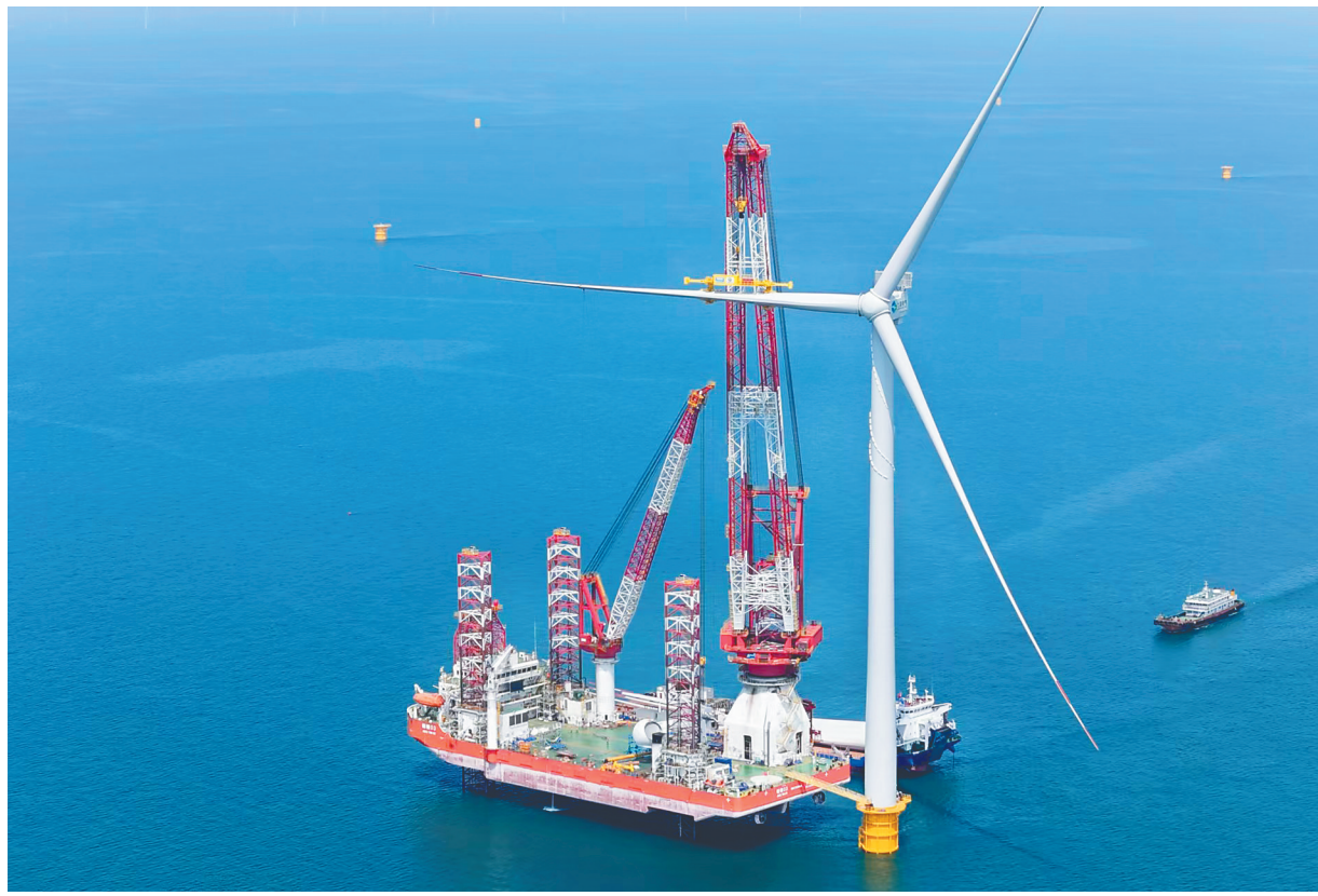
海上风电安装平台“精钢03”号吊装现场。申能海南CZ2海上风电示范项目方供图
