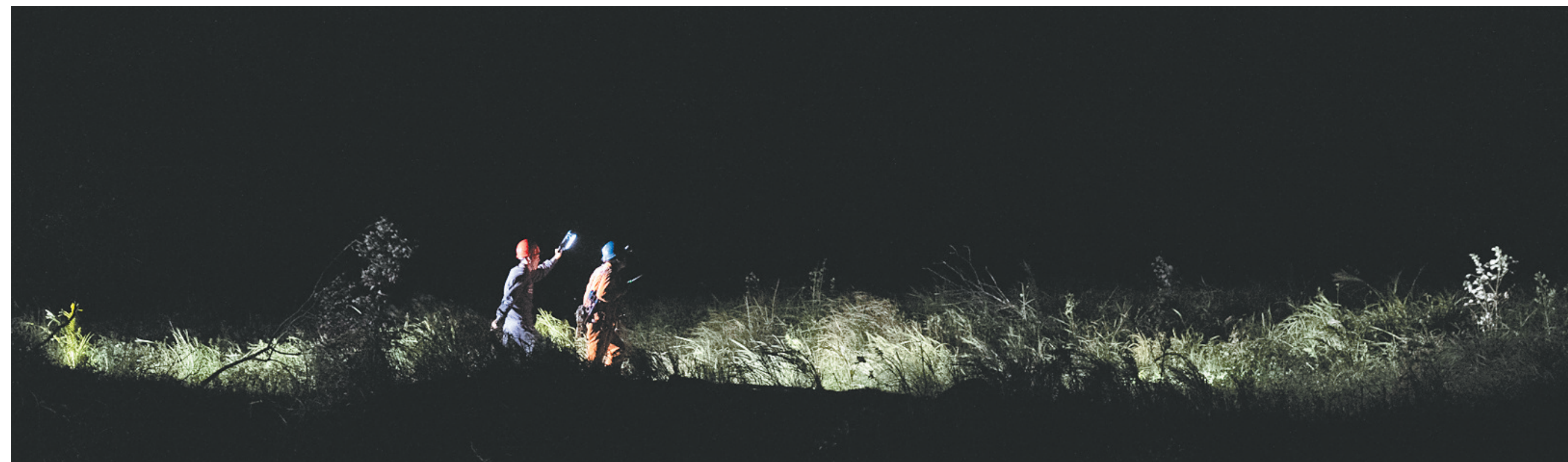
▲9月18日晚的海口市美兰区三江镇道美村，南方电网广东茂名供电局支援海南抢修队在杂草中前行，冒雨抢修10千伏红化线。 本版图片除署名外均由海南日报全媒体记者 李天平 摄
