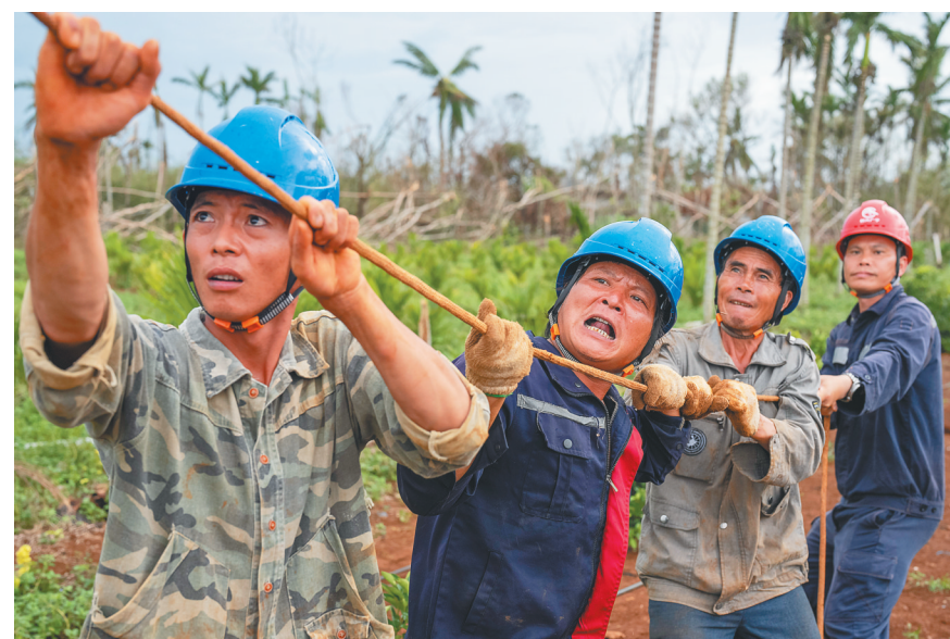
◀9月19日，在海口市琼山区红旗镇，南方电网广东肇庆供电局支援海南抢修队合力将导线拉上电线杆。经过多方数日昼夜奋战，海口东山、云龙、红旗等镇中心区域已基本恢复正常供电。
