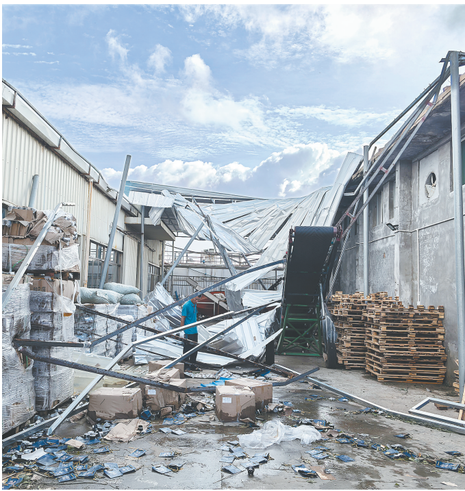
被台风“摩羯”摧毁的海口东昌胡椒有限公司仓库。
