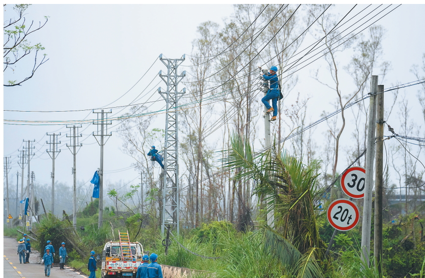
近日，在海口市龙华区遵谭镇158县道上，南方电网广东中山供电局支援海南抢修队加紧抢修10千伏线路。 海南日报全媒体记者 李天平 摄
