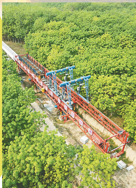
琼西北供水工程排浦分干渠七号渡槽修建现场。中国水利水电第八工程局有限公司供图
