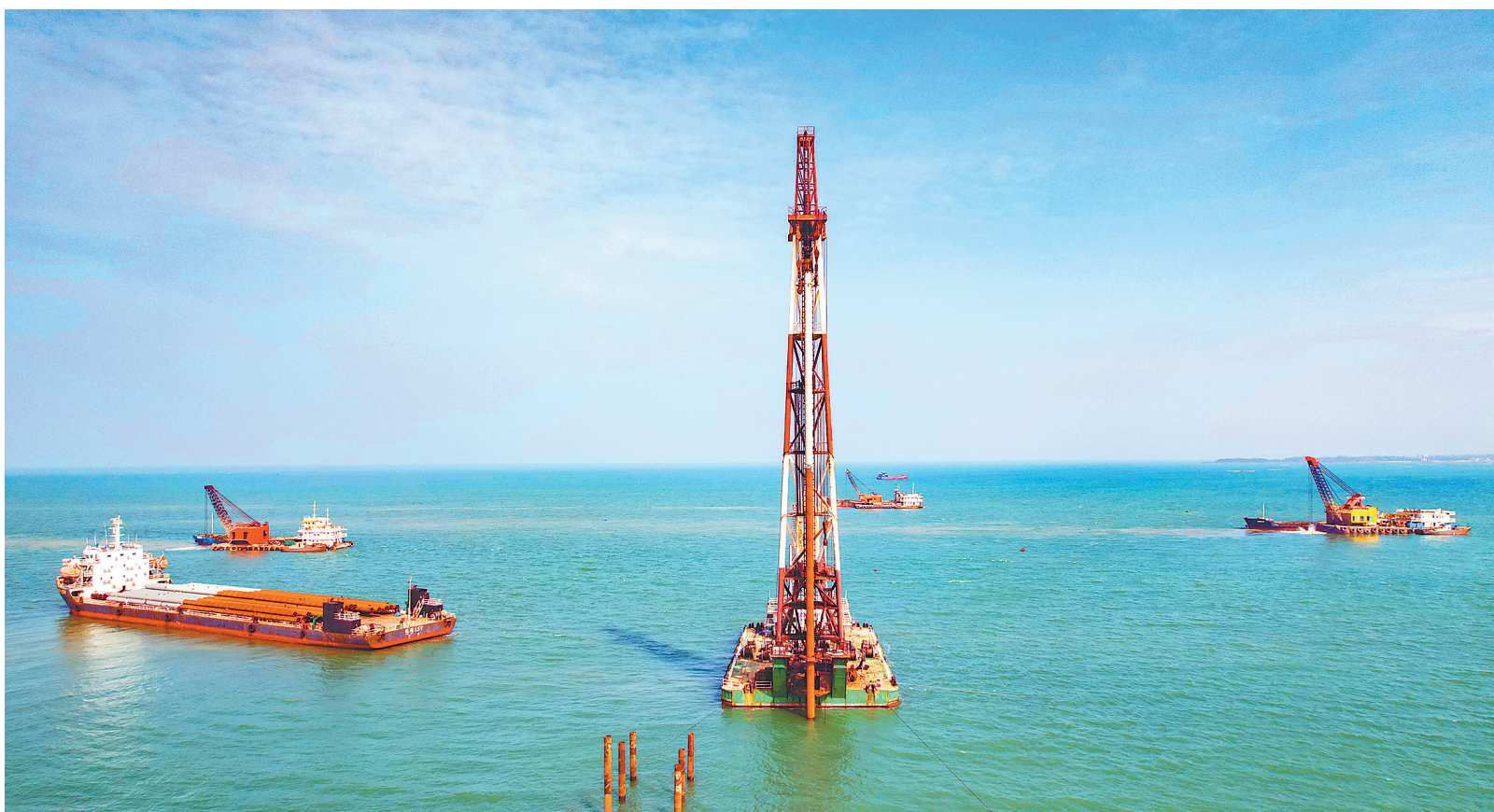
临高金牌港开发区港口及配套工程项目一期首根钢管桩成功沉桩
