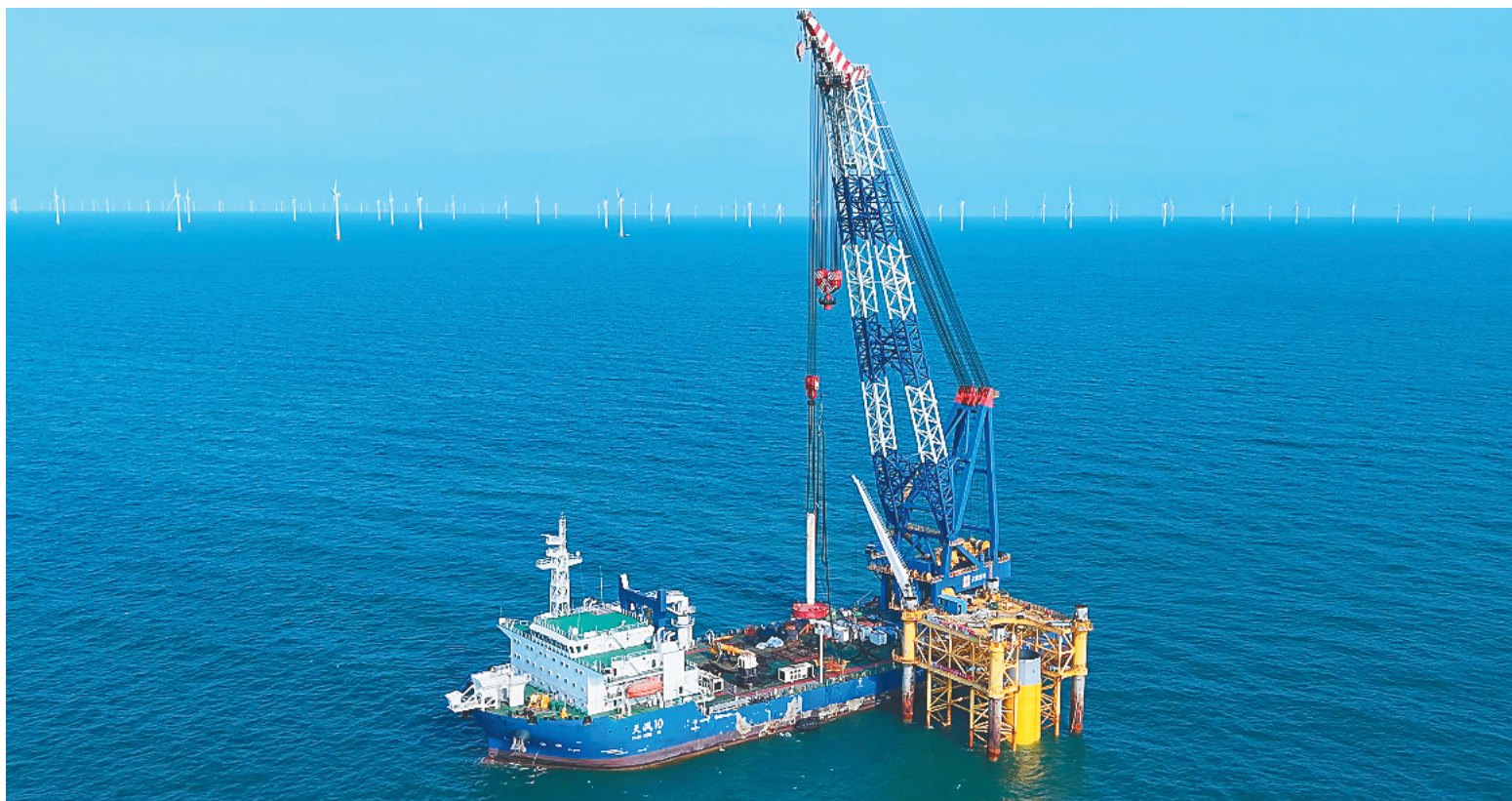
申能海南CZ2海上风电示范项目一期首桩入海。中国铁建港航局供图
