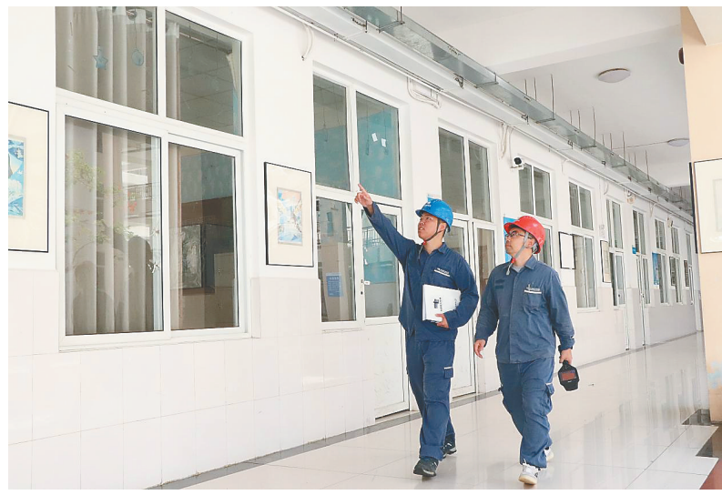
三亚供电局对考点供电线路、变压器、配电箱等电力设施开展排查。 卢瑾 摄
