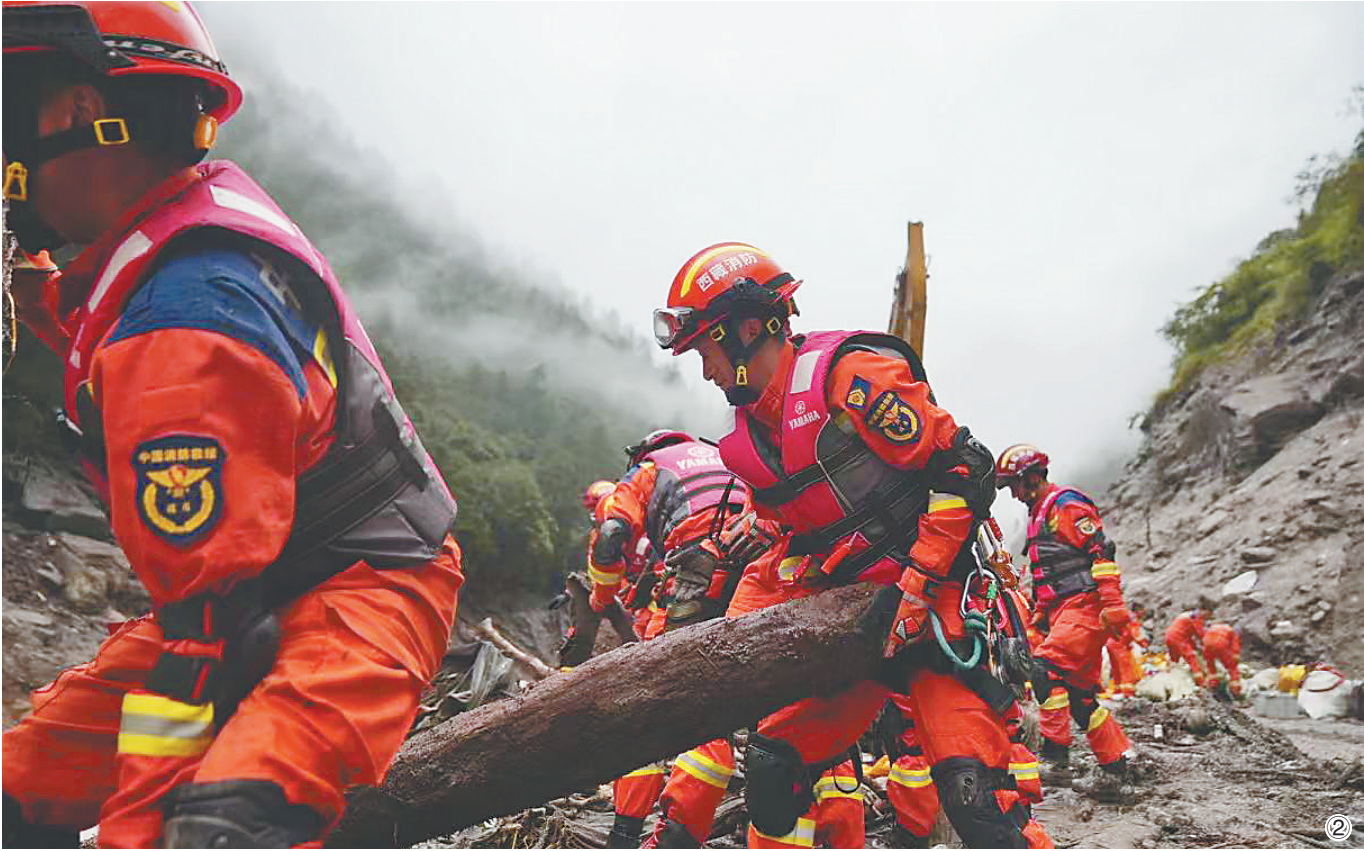
① 8月29日,救援力量持续对G216国道损毁路段全力开展抢通作业,用于填充被冲毁路基的石方陆续抵达。新华社记者 晋美多吉 摄 ② 8月29日,救援力量集结向吉隆口岸泥石流灾害现场挺进。新华社记者 旦增尼玛曲珠 摄
