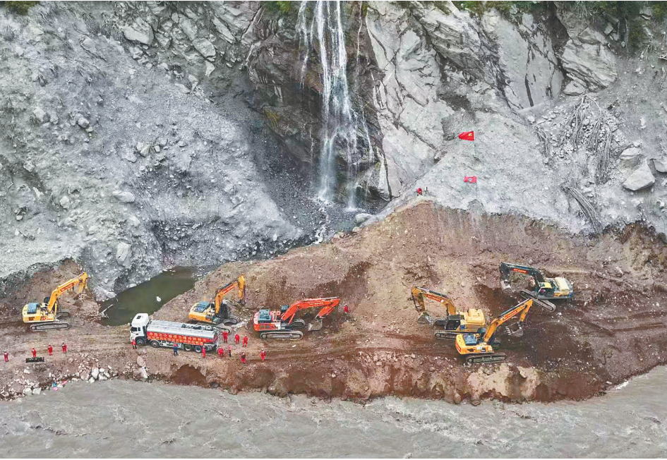
9月1日18时许,G216线受吉隆泥石流灾害冲毁的道路已抢通至距离吉隆口岸剩余700米。这是9月1日拍摄的道路抢通现场。 新华社发
