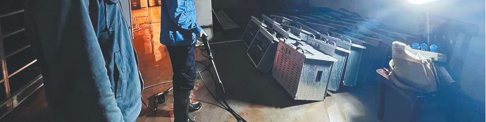
海南电网五指山供电服务中心对平山医院配电柜和配电室开展用电检查。
