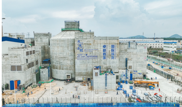
全球首个陆上商用模块化小型堆“玲龙一号”。本组图片均由海南核电提供
