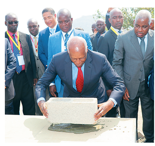
中企在安哥拉承建的非洲最大水电站开工。8月4日,安哥拉总统多斯桑托斯(中)在该国北宽扎省栋多市为卡库洛卡巴萨水电站项目开工进行奠基。据介绍,这是目前中资企业在非洲承建的最大水电站。 新华社发(许昆鹏 摄)
